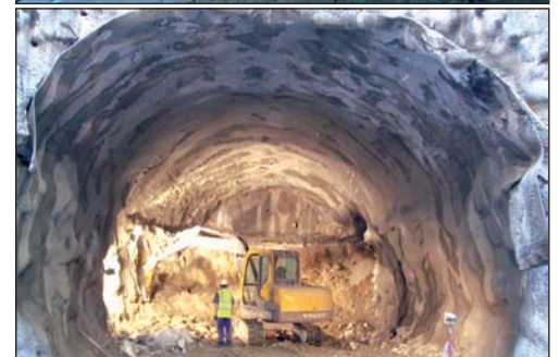
Inicio de la excavación en avance (arriba) y destroza (abajo) de la galería de conexión con el pozo de Havaneres.
