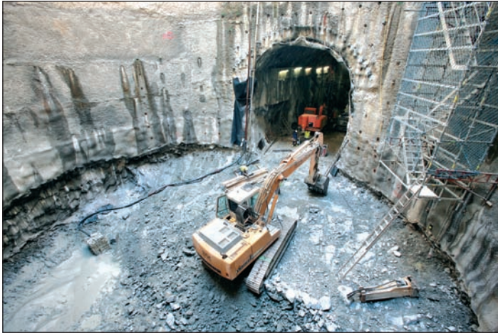
Reprofundización del pozo de ventilación y de la galería de conexión para ganar en altura suficiente para el cambio de la cabeza de corte de la tuneladora (Foto: GISA).
