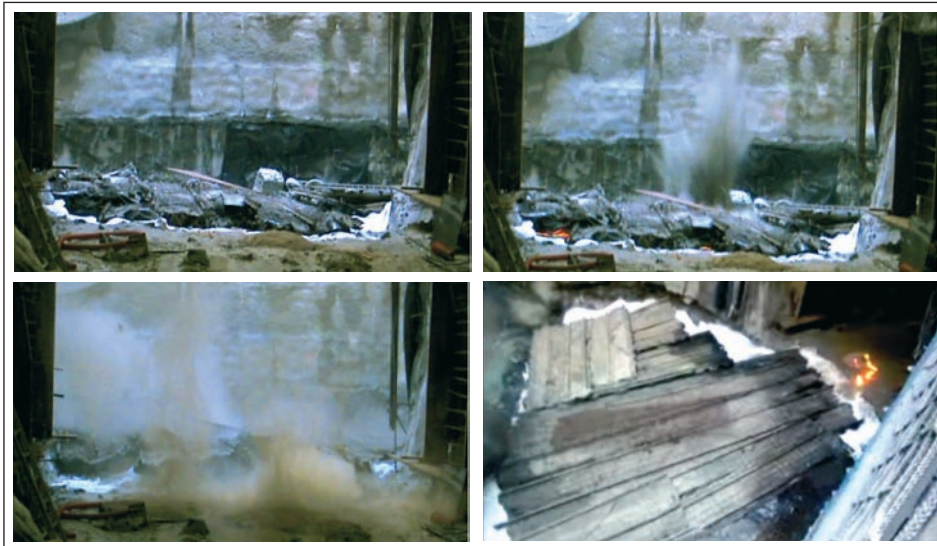
Secuencia de una voladura. Las auditorías revelaron puntos a reforzar/revisar en los blindajes de contención para incrementar la seguridad frente a proyecciones.
