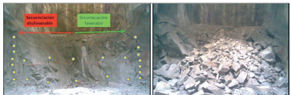
[Figura 2].- Frente de voladura de destroza, iniciada en el centro. Obsérvese cómo la componente hacia la izquierda provocaba un dislocamiento prematuro de bloques en detrimento de una buena fragmentación y daños al hastial izquierdo.
